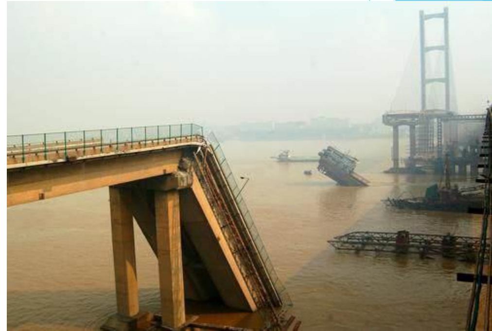
6.15九江大桥坍塌事故 (2007)
