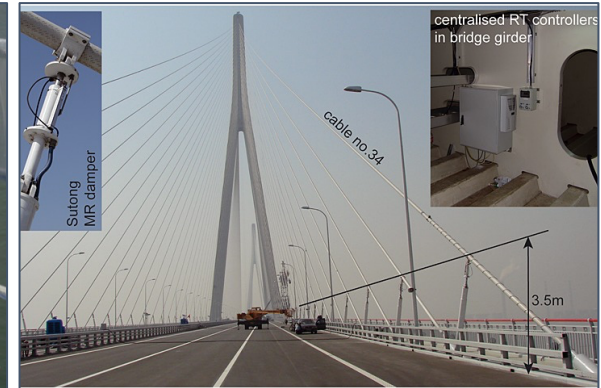
苏通大桥上安装的MR阻尼器
